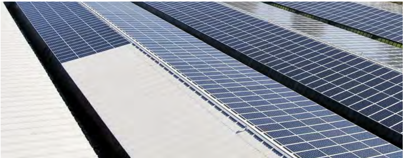
Impianti fotovoltaici su edifici industriali ↑
