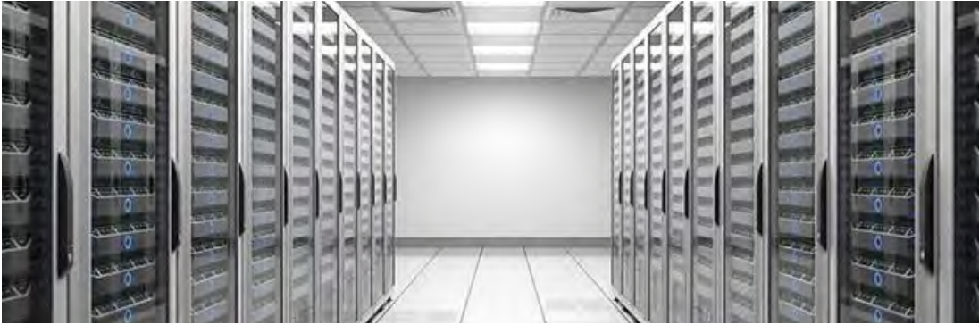
↑ Necessità strategiche datacenter
