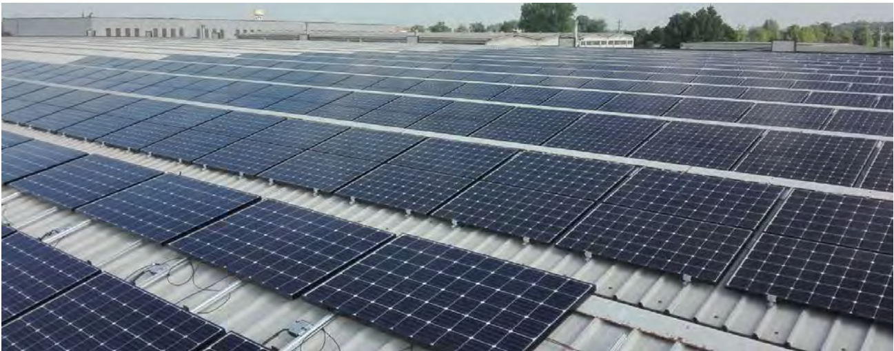
Impianti fotovoltaici su edifici commerciali ↑
