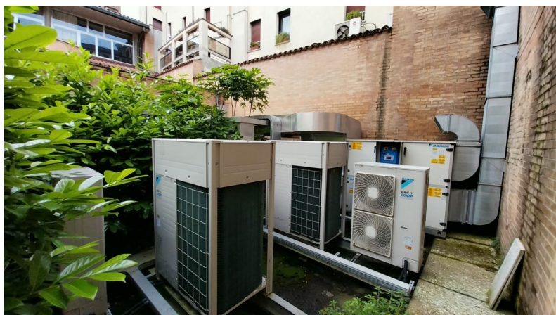
Foto 15: Macchine esterne impianti climatizzazione
